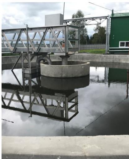
Рисунок 9. Очистные сооружения «Птичное»
